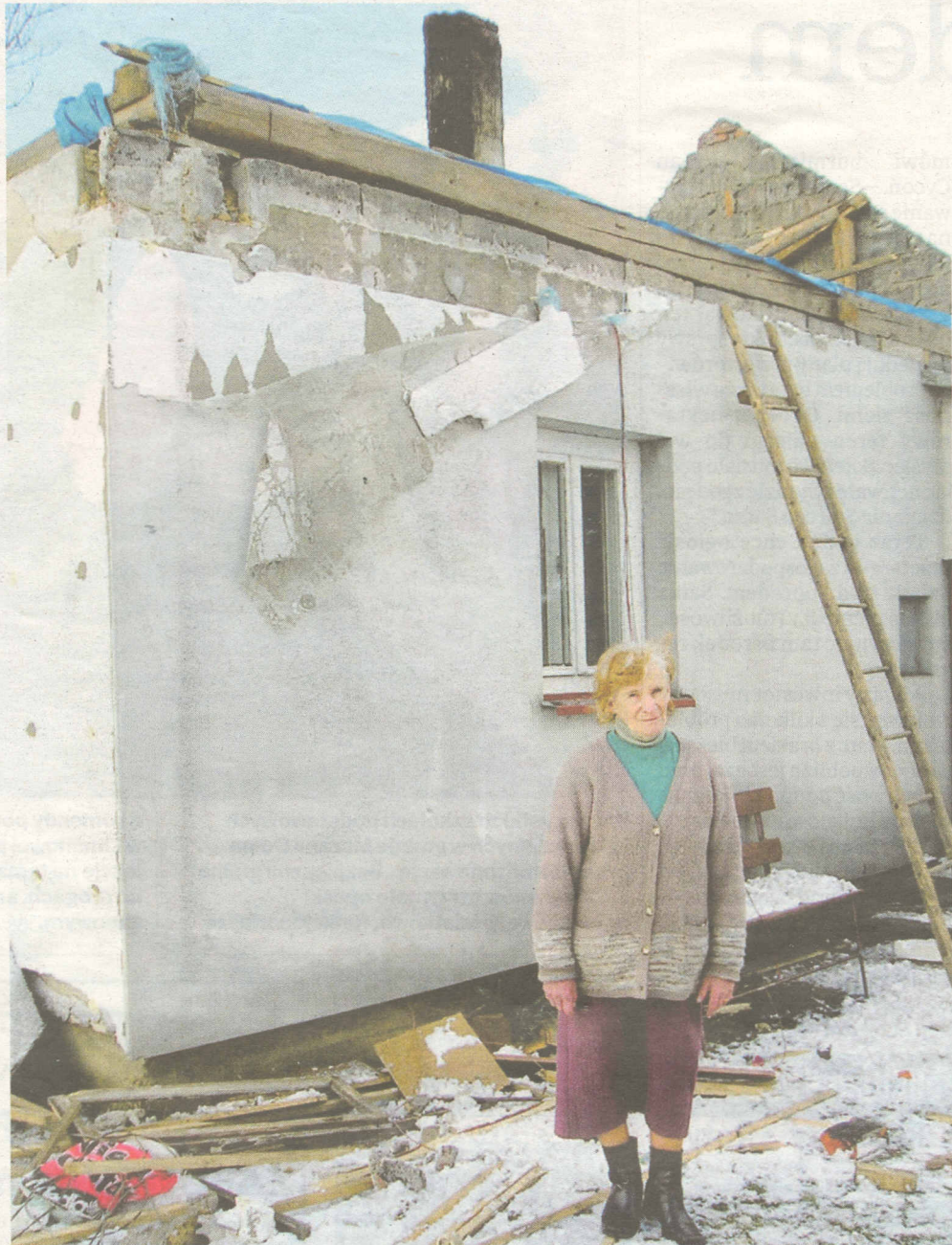
Kazimiera Ferenc na pobojuwisku – w nocy wichura zerwała nowy dach z jej domu
