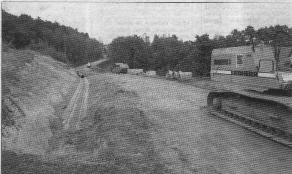
Gmina Korzenna otrzymała pieniądze na najpilniejsze remonty. To jednak wciąż za mało, aby zlikwidować wszystkie powodziowe zniszczenia
